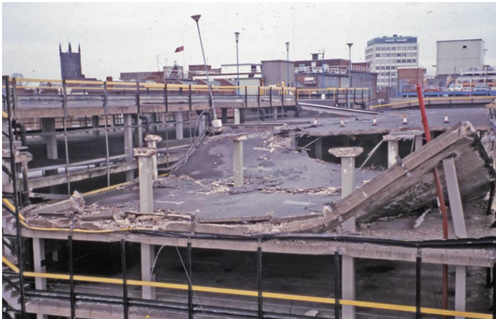
Figura 1 – Efeito de punção no edifício-garagem Pipers Row.
