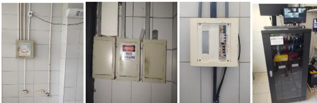
Figuras 3: Instalações elétricas (A) , quadro de energia (B e C) e equipamentos internos (D)
