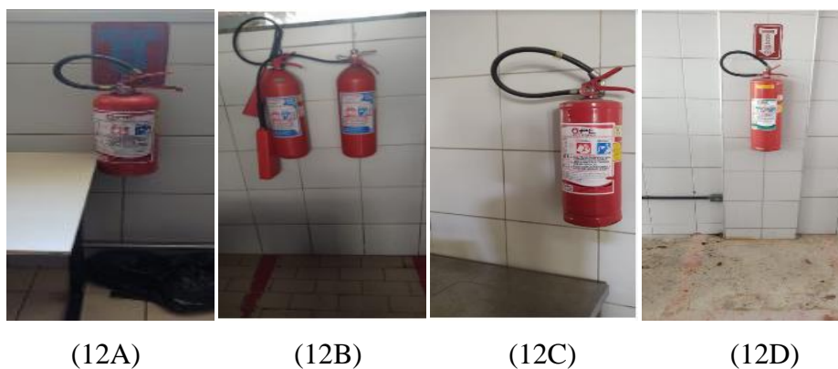
Figuras 12: Extintores em desacordo com a legislação na cozinha (A, B e C), extintores em desacordo com a legislação no salão (D)
