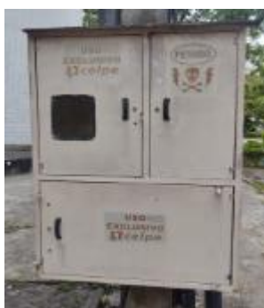
Figuras 4: Quadro de energia
