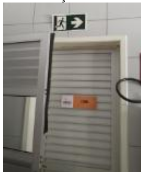
Figuras 9: Sinalização de saída da cozinha
