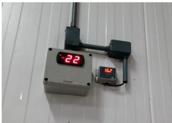
Figura 5 - Temperatura da antecâmara de estocagem (esquerda) e temperatura da expedição (direita)
