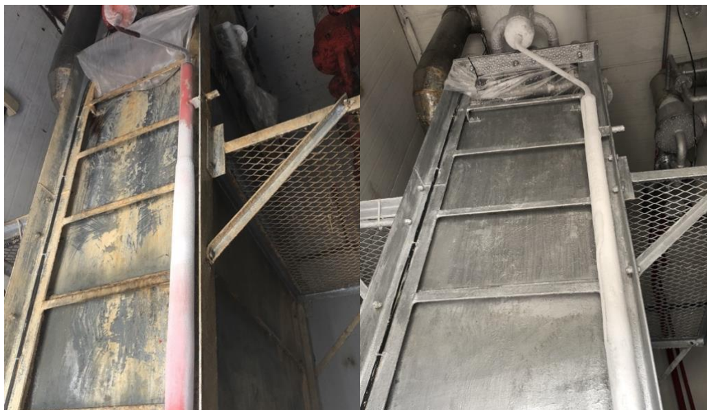
Figura 47 e Figura 48. VOEC. PPHO e manutenção (antes e depois). À esquerda, máquina de gelo com sujidades e incrustações e presença de oxidações no teto e equipamento. À direita, equipamento limpo e com manutenção realizada. A ação tomada com relação à higiene foi imediata, pois gerava risco direto ao produto. Fonte: Arquivo pessoal/ SIF (2021).
