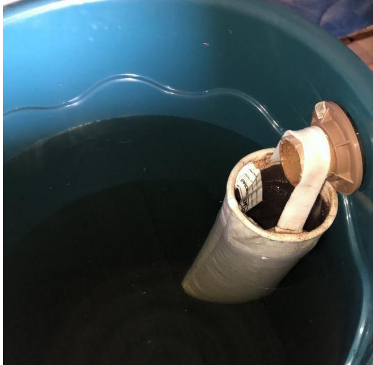
Figura 18. Filtro de saco de 50 micras instalado na passagem de água.
