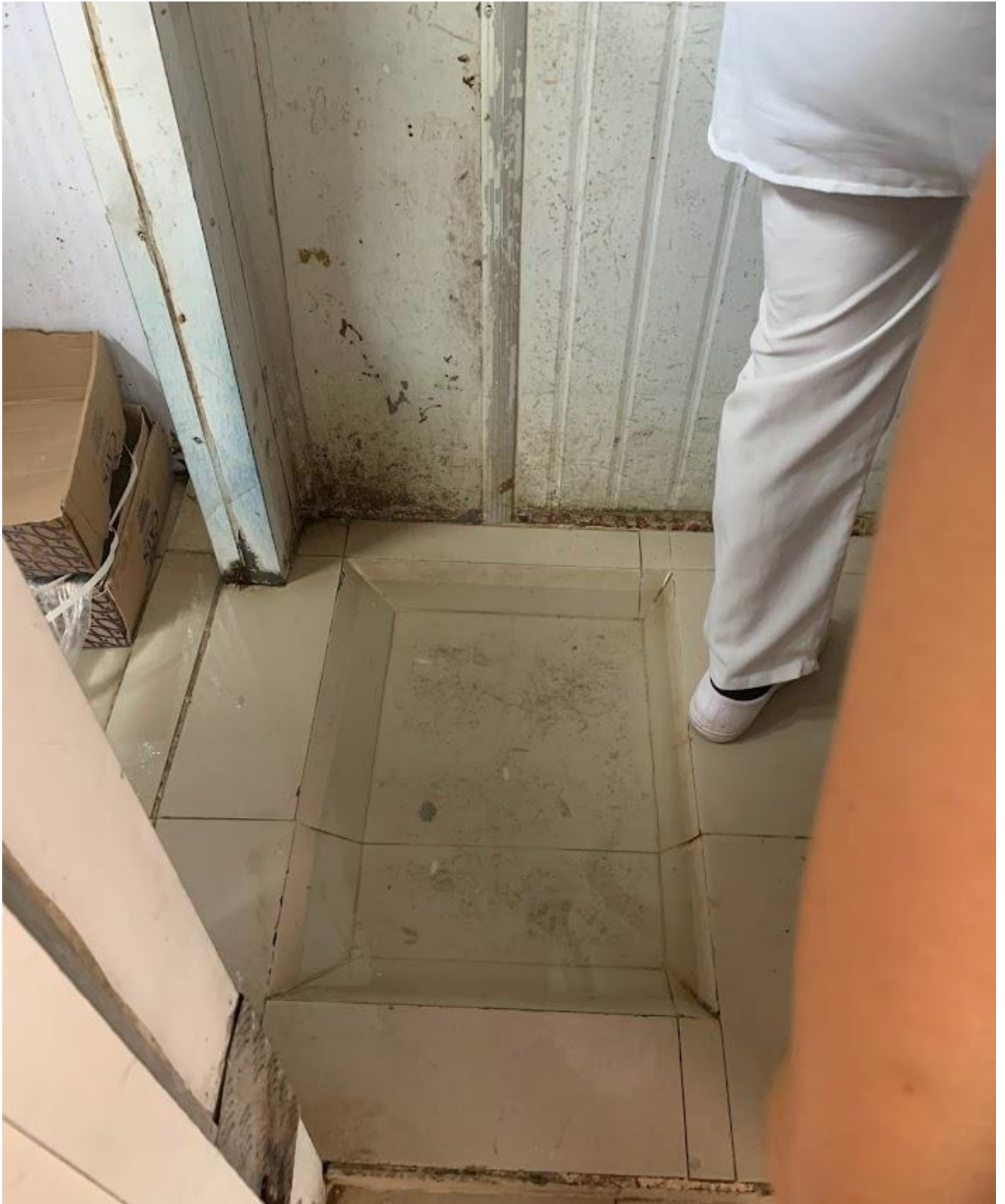
Figura 18: Barreira sanitária com acúmulo de águas residuais. Fonte: arquivo pessoal, 2022.
