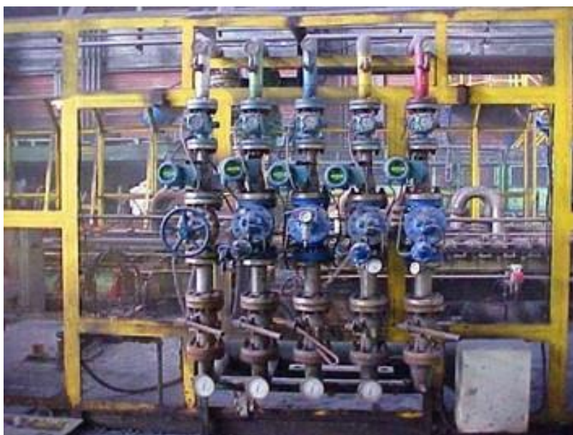
Figura 31 – Tubulações de alimentação de água do Thermex
