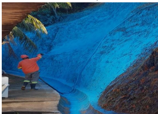
Figura 7: Aplicação de gel na encosta da 3ª Trav. Lisboa, 14.
