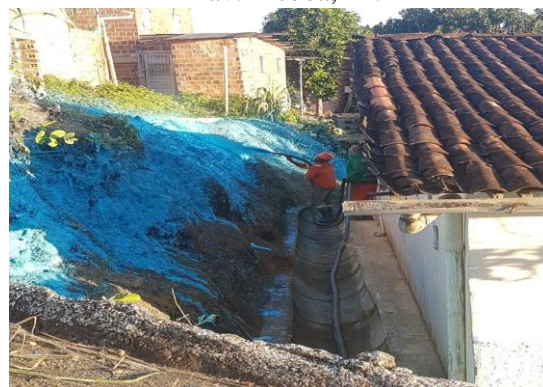
Figura 6: Aplicação de gel na encosta da 3ª Trav. Lisboa, 14.
