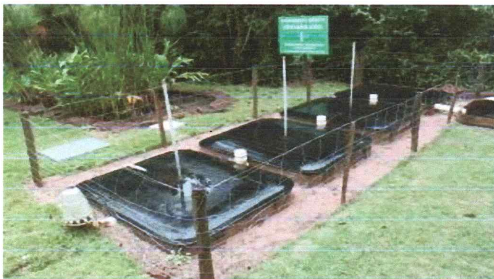
Figura 1 – Fossa Séptica Digestora
