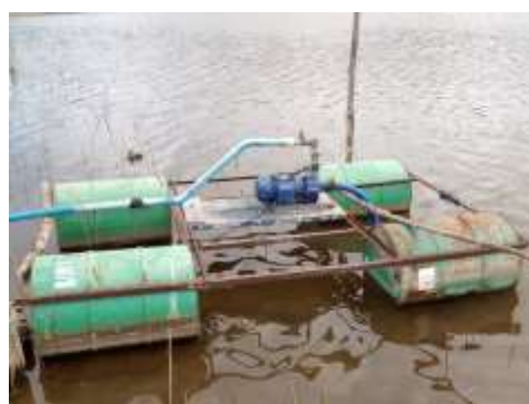
Figura 19. Conjunto moto bomba.
