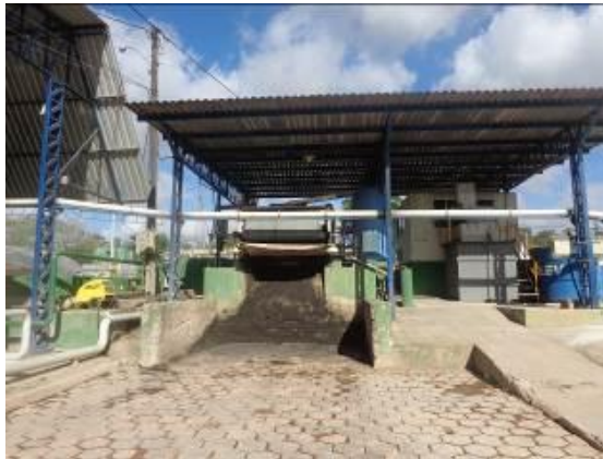
Figura 3 - Destorrador utilizado na ETE Curado
