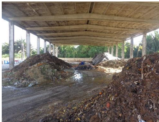
Figura 4 - Pátio de compostagem na ETE Curado
