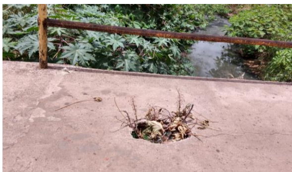
Figura 2. Buraco na ponte do Rio Anil
