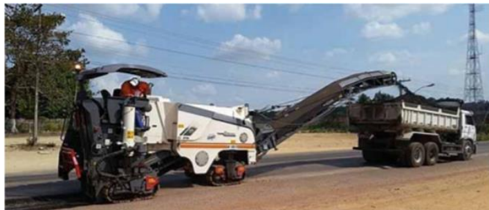
Figura 3. Equipamento realizando a fresagem de revestimento asfáltico flexível com geração de material fresado.
