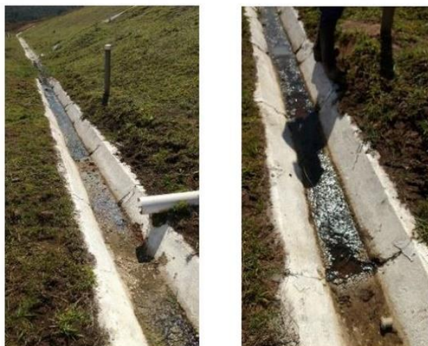
Foto 12 – Surgência de água na canaleta próxima a segunda trincheira (da ombreira direita para esquerda) na bermã na EL. 899 m.
