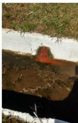
Foto 13 – Presença de coloide na saída do dreno interno que desagua no canal da segunda trincheira (da ombreira direita para esquerda) na bermã na EL. 899 m.
