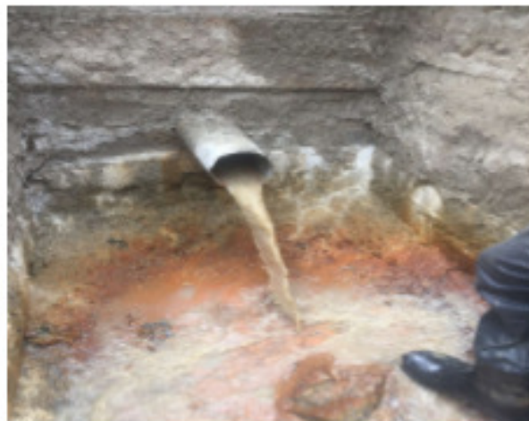
Sistema em Funcionamento
