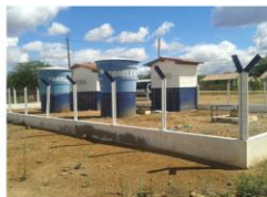
Figura 2. Caixas d'água acopladas ao dessalinizador.
