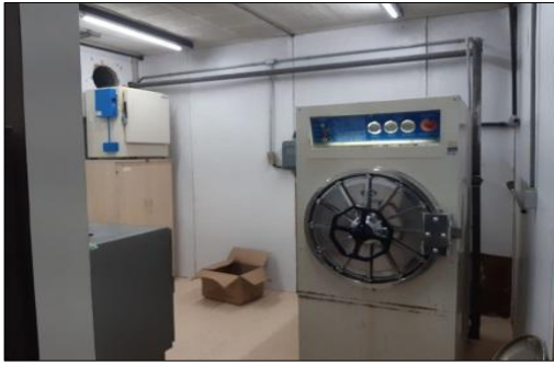
Figura 3. Autoclave hospitalar da sala de esterilização do HV/UFRPE. Fonte: Arquivo Pessoal, 2019.
