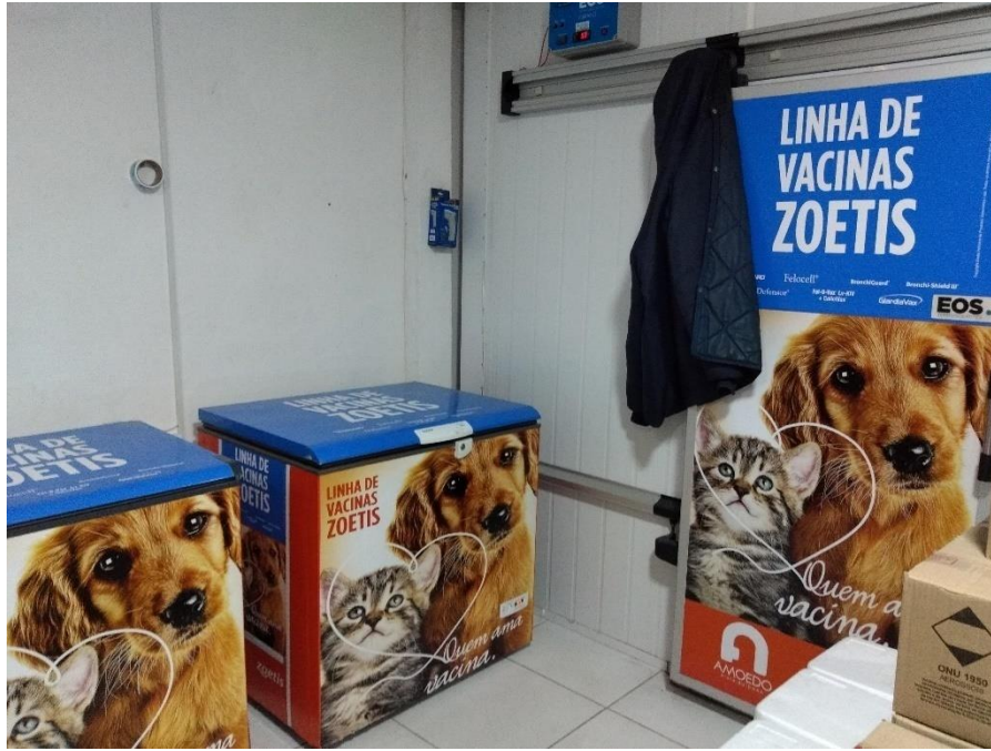
Figura 9: Câmara fria para estoque das vacinas da empresa Amoedo Distribuidora. Fonte: Arquivo pessoal (2019).
