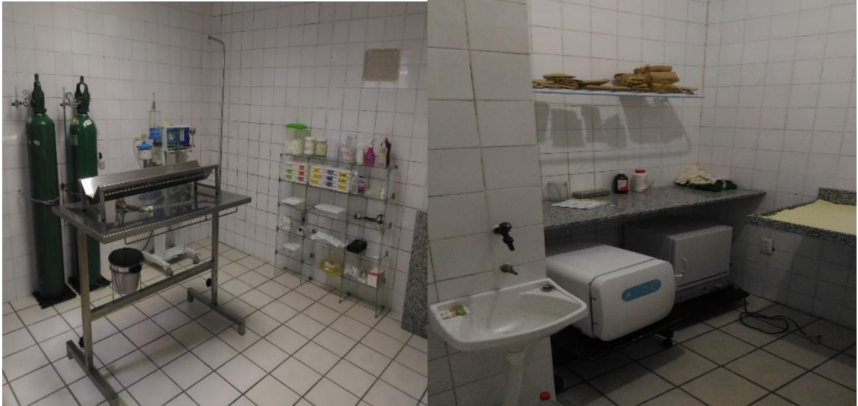
Figura 5. Bloco cirúrgico com mesa cirúrgica e aparelho para anestesia inalatória, sala de esterilização com autoclave e estufa. Fonte: Arquivo pessoal.
