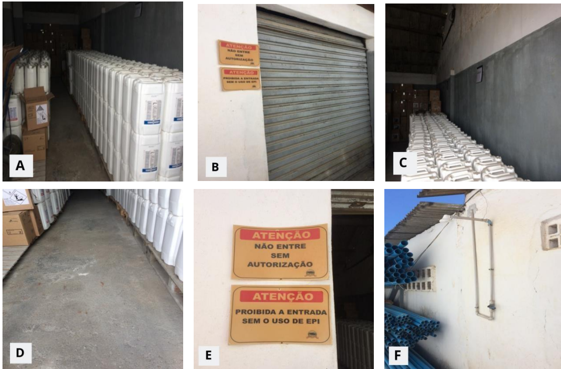
Figura 19: Área compatível com o material estocado (A), Porta com acesso exclusivo (B), Parede de alvenaria de superfície plana revestida com tinta óleo, (C), Piso de material antiderrapante (D), Letreiro de advertência na porta (E), Chuveiro de emergência (F), Agroseiva, Garanhuns, 2019.
