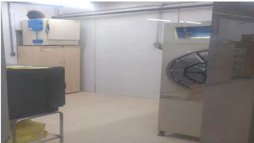
Figura 11 – Sala de Esterilização de Materiais do Hospital Veterinário da UFRPE.
