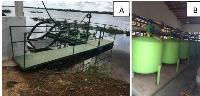
Figura 27- Captação de água no rio São Francisco (A). Sistema de filtragem da água do rio (B).
