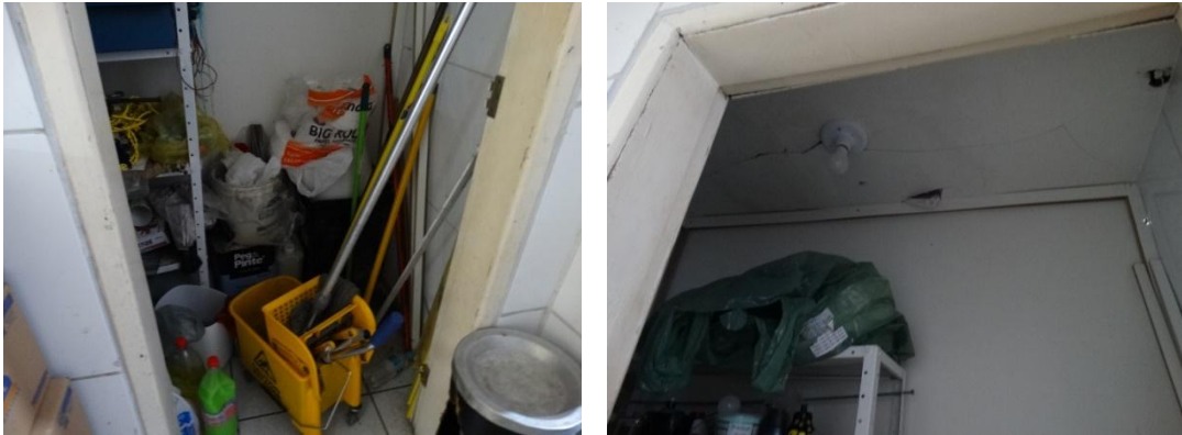
Figura 17. DML desorganizado, objetos estranhos, material mal armazenado e teto rachado.
