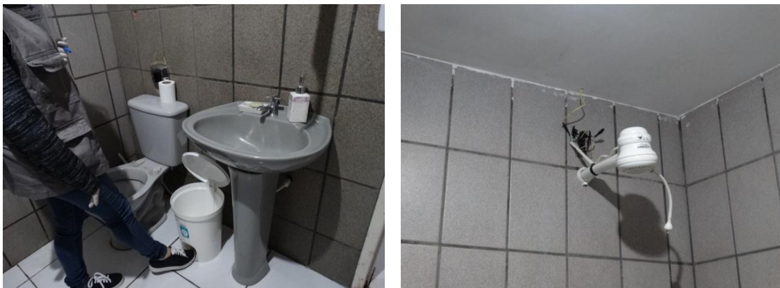
Figura 5. Recipiente de lixo sem saco, vaso sanitário sem assento e tampa, fiação exposta no chuveiro.
