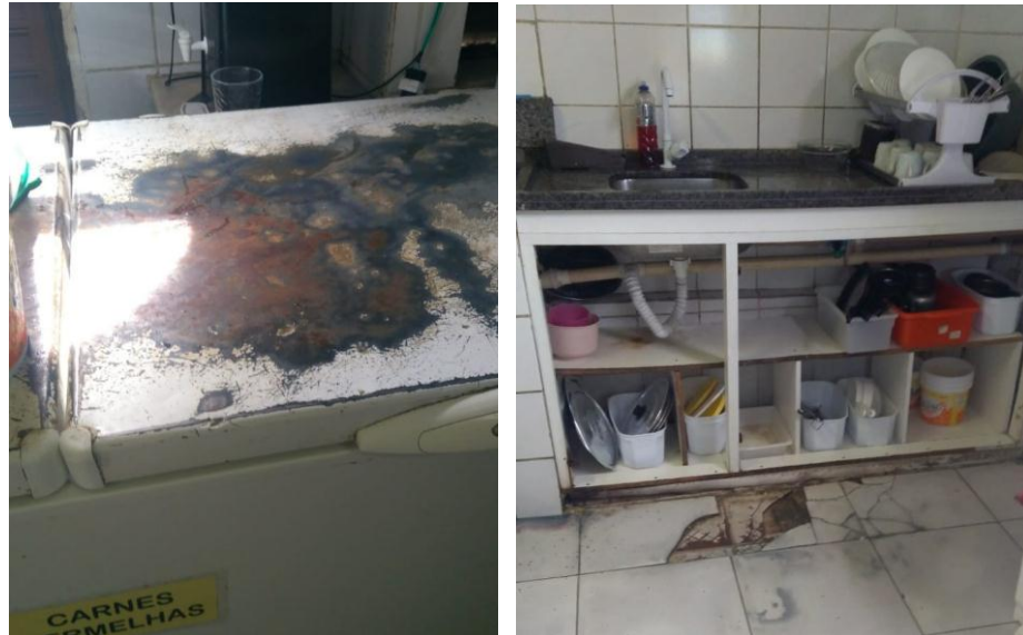
Figura 8. Freezer com ferrugem e piso com cerâmica quebrada na área da manipulação.
