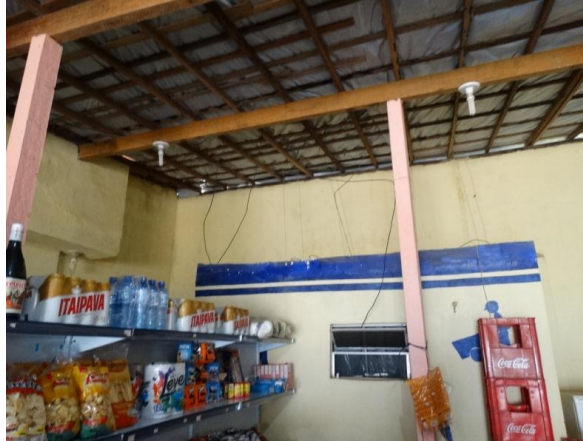
Figura 23. Teto de material não lavável e fiação exposta.
