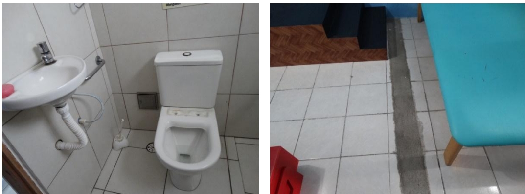
Figura 3. Vaso sanitário sem assento e tampa e piso com cerâmica quebrada.
