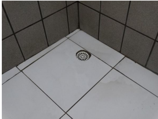
Figura 6. Ralo do banheiro aberto, sem tampa sifonada.
