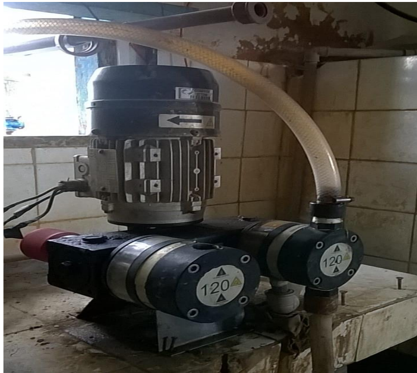
Figura 8 - Bomba dosadora utilizada para dosagem do sulfato de alumínio (Al 2 (SO 4 ) 3 ).
