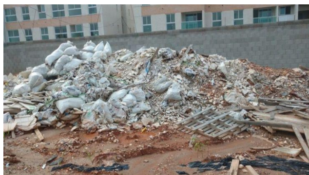
Figura 8 - Descarte de resíduos sem separação prévia, averiguado no canteiro de obras da empresa D
