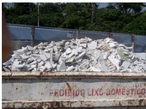
Figura 1 - Segregação do gesso na obra
