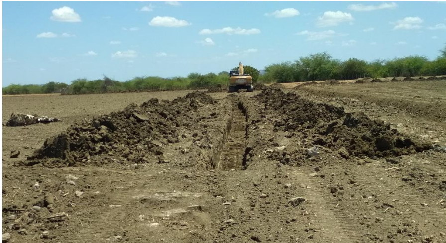
Figura 23. Vistoria em operação de instalação de tubulação de irrigação localiza escavação incoerente com o percurso projetado, inviabilizando instalação do sistema.
