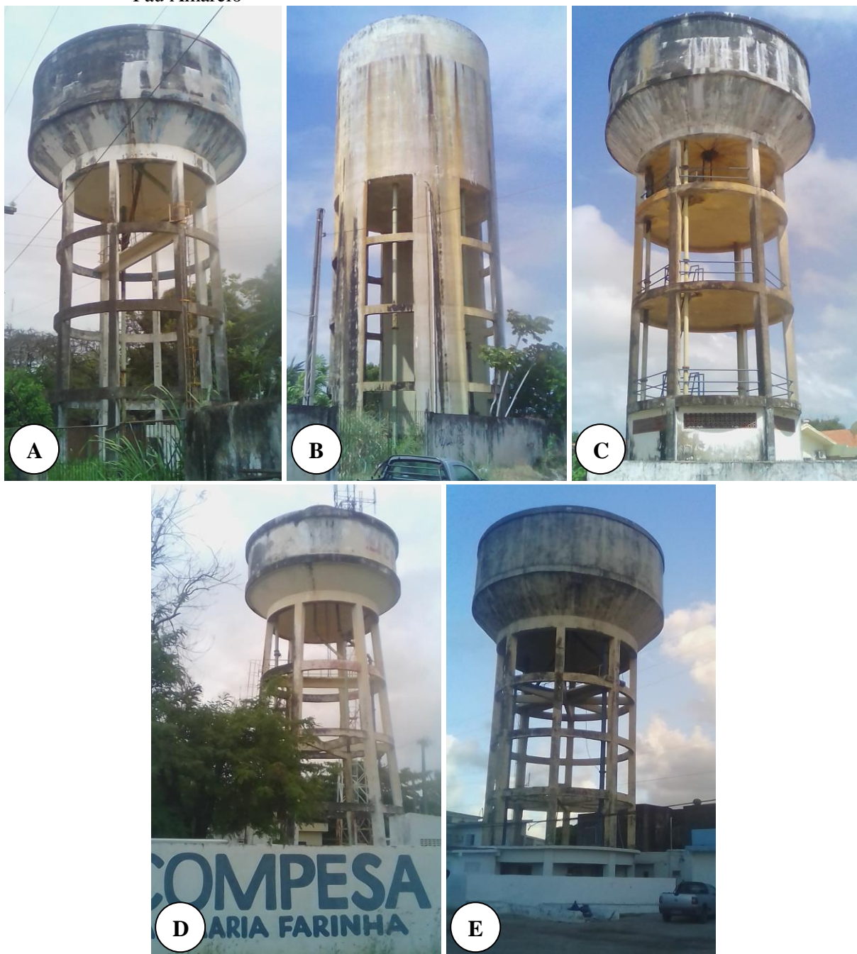
Fotografia 1 - Reservatórios de água da Companhia Pernambucana de Saneamento (Compesa), no município de Paulista-PE: A-Indaiá; B-Portugal; C-Conceição; D-Maria Farinha; E-Pau Amarelo
