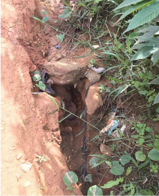
Figura 4- Ravinas no solo, ocasionada por erosão hídrica.
