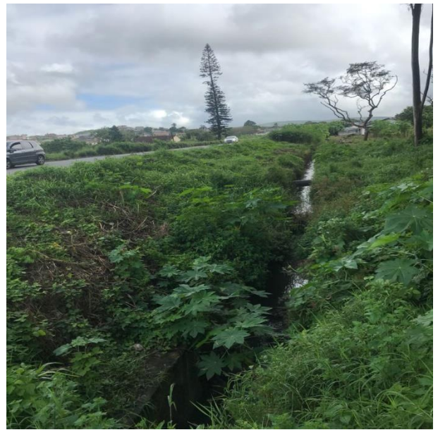
Figura 11 - Esgoto à céu aberto;
