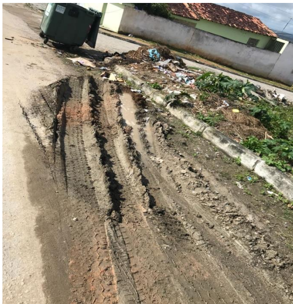
Figura 13 – acúmulo de sedimentos na pavimentação
