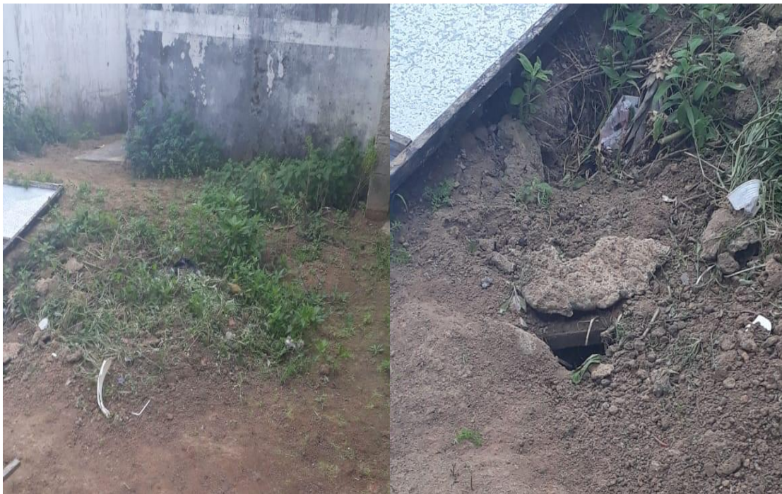
Fotografia B2 – Fossa / Buraco. Dia 08/08/2018
