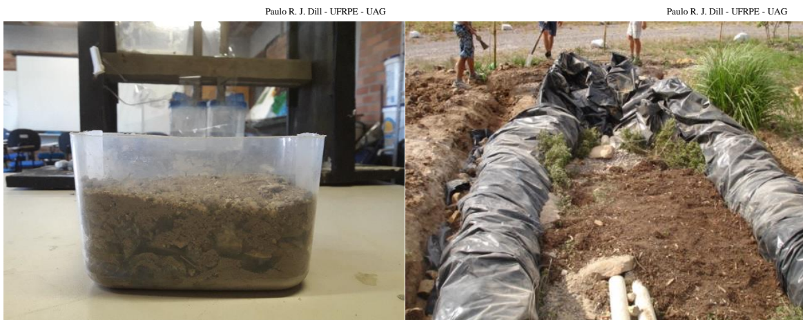
Figura 16 – Pote plástico com brita e areia representando a etapa de colocação de areia e terra vegetal na construção da fossa ecológica. Figura 17 – Fossa ecológica com areia e terra vegetal depositados.
