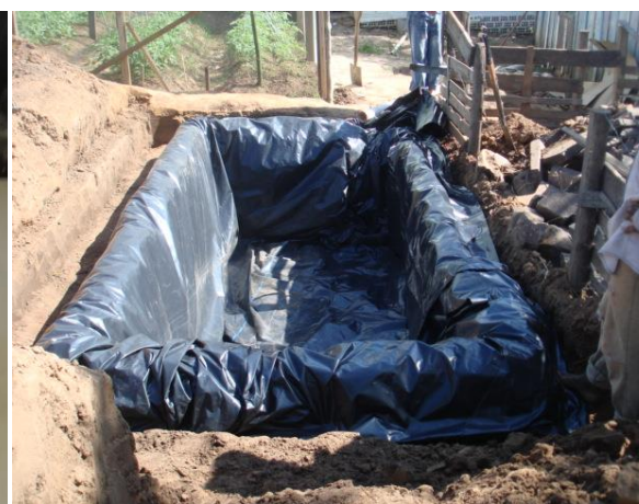
Figura 13 – Lona plástica cobrindo estrutura de alvenaria.
