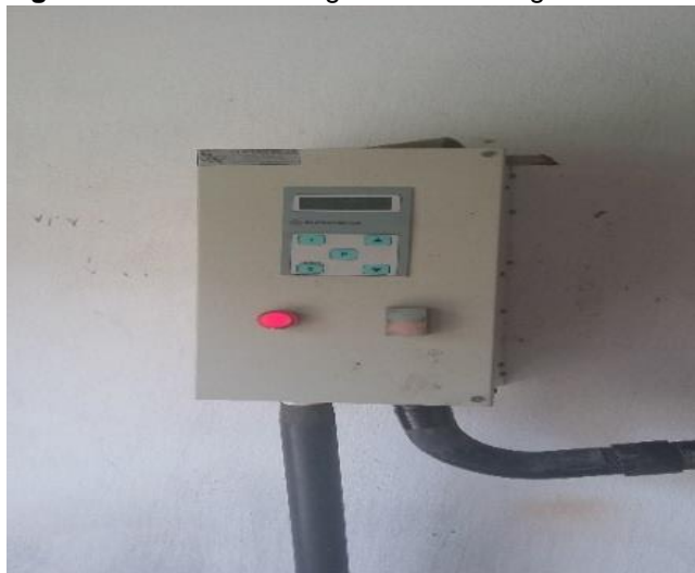
Figura 26 - Sistema de ligamento e desligamento das bombas.
