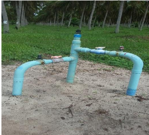
Figura 28 - Válvulas de distribuição de água.
