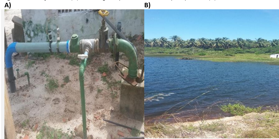
Figura 24 - Poço direto (A) e Barragem que atende os tanques pulmão (B).
