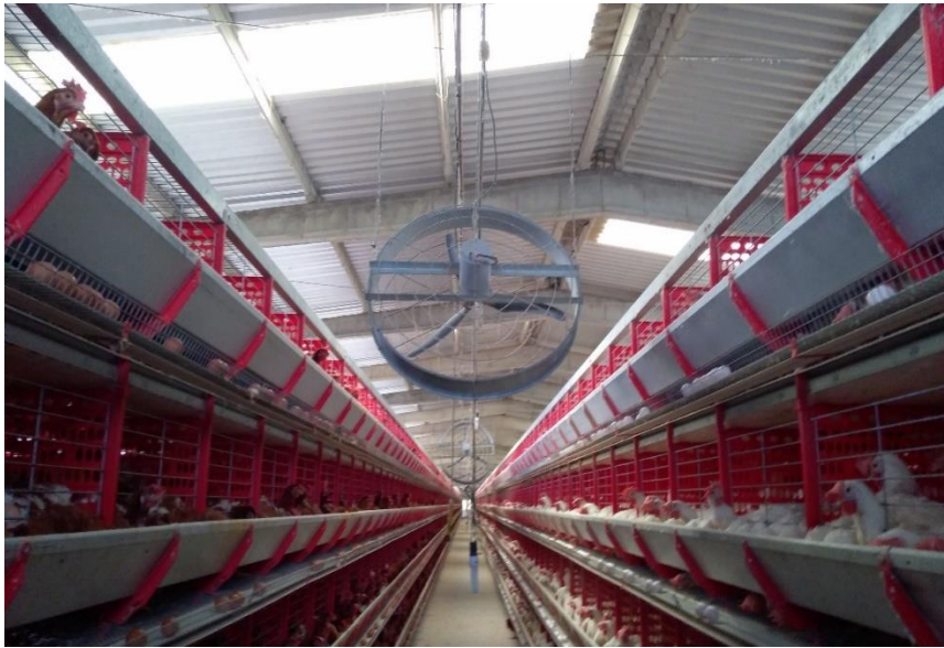
Figura 13 - Disposição dos ventiladores.
