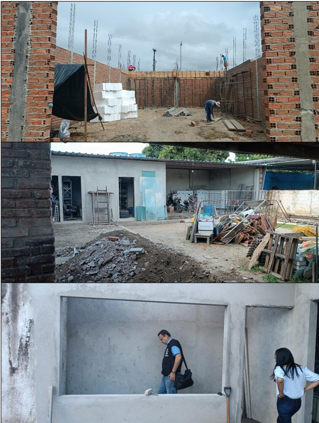
Figura 7. Registro de construções começadas antes da aprovação das plantas baixas.
