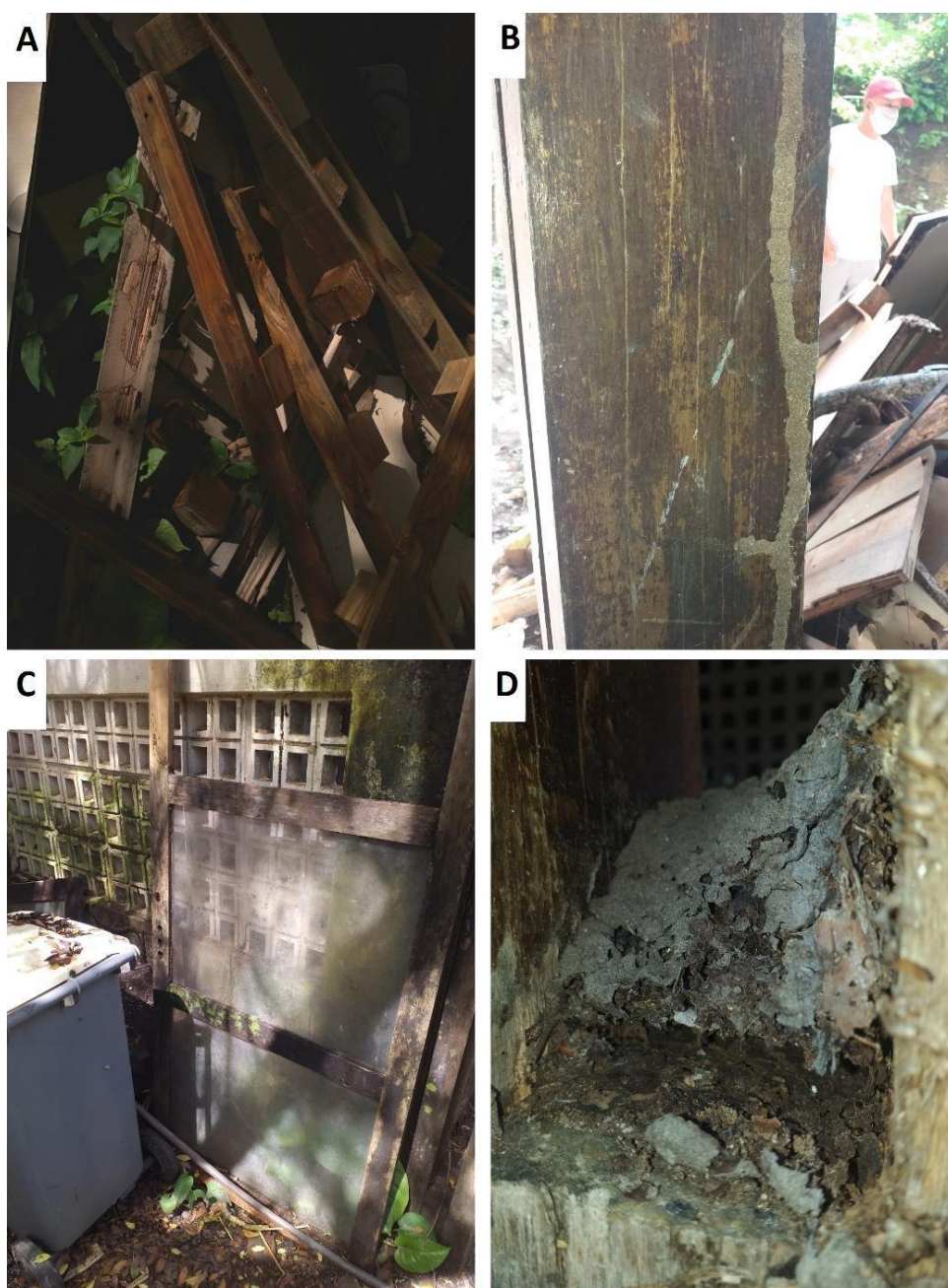
Figura 4 - Materiais abandonados no Prédio de Anatomia. A: Pedações de paletes encontrados durante a vistoria no local, com presença de trilhas ativas. B: Trilha de cupim localizado em um forro de madeira. C: Parte de uma porta com forro de madeira com presença de trilhas ativas de cupins. D: Ninho de cupim da família Nasutitermitinae localizado em um pedaço de madeira. Fonte: Acervo da autora.
