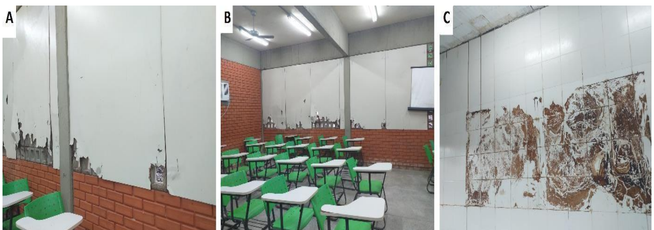
Figura 3 - Interior do Prédio de Anatomia. A e B: Danos causados por cupins em forros de Eucatex localizado em uma sala de aula do prédio. C: Marca deixada pelos termitas após ataque ao forro de um quadro branco que se conectava a parede do local. Fonte: Acervo da autora.
