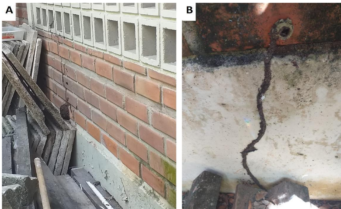
Figura 7 - Setor de Manutenção do Departamento de Logística e Soluções. A: Deposição incorreta de placas de concreto, madeiras e lixo na área externa do setor de Manutenção, com presença de ninho da espécie N. corniger em meio as placas. B: Perfurações na parede que permitiam o acesso da espécie à área interna do local. Fonte: Acervo da autora.
