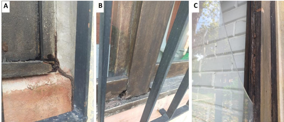
Figura 6 - Departamento de Tecnologia Rural. A-C: Danos causados pelos cupins nos forros de janelas do departamento. Fonte: Acervo da autora.
