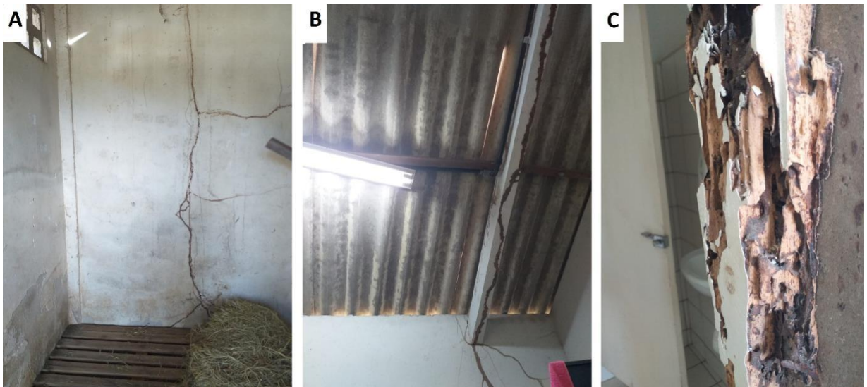
Figura 9 - Núcleo de Pesquisa Equina do Departamento de Zootecnia. A: Trilhas inativas nas paredes do local. B: Trilhas inativas também foram observadas nas ripas de madeira. C: Dano expressivo causado pelos cupins a um forro de porta. Fonte: Acervo da autora.
