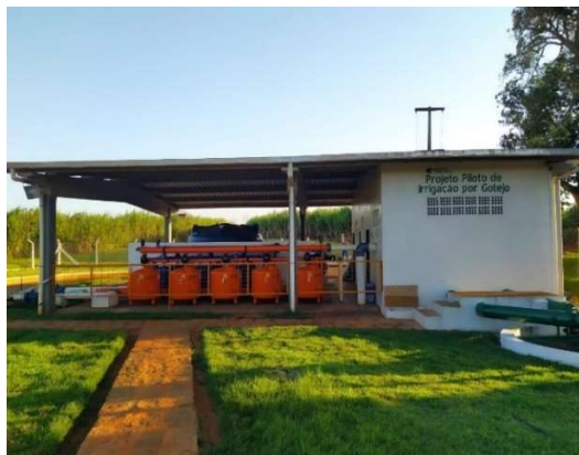
FIGURA 14 – CASA DE BOMBAS DO GOTEJO
