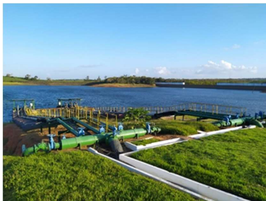
FIGURA 13- CAPTAÇÃO DE ÁGUA NA BARRAGEM GUARAREMA
