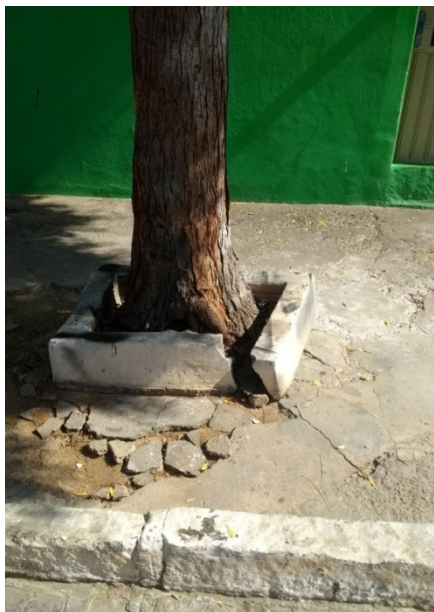
Figura 13: Danificação de calçadas no Bairro Alto da Conceição, Serra Talhada/PE, 2018.
